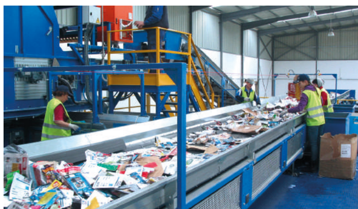
Sorting conveyor Bandă transportoare de sortare
